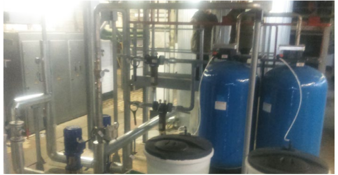
4 nuotrauka. Cheminio vandens paruošimo sistema ir vandens į vakuuminį deaeratorių padavimo sistema +0 lygyje
