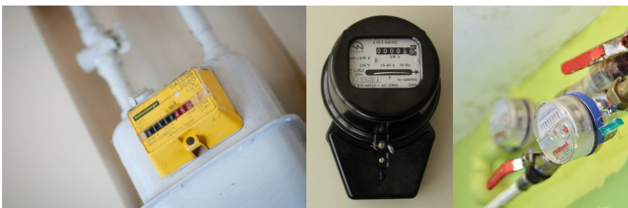
Daugiabučių namų gyventojai už dujas, elektros energiją ir šaltą geriamąjį vandenį atsiskaito pagal butuose įrengtų apskaitos prietaisų rodmenis
