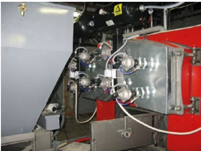
Pneumatinė katilo dūmavamzdžių valymo sistema
