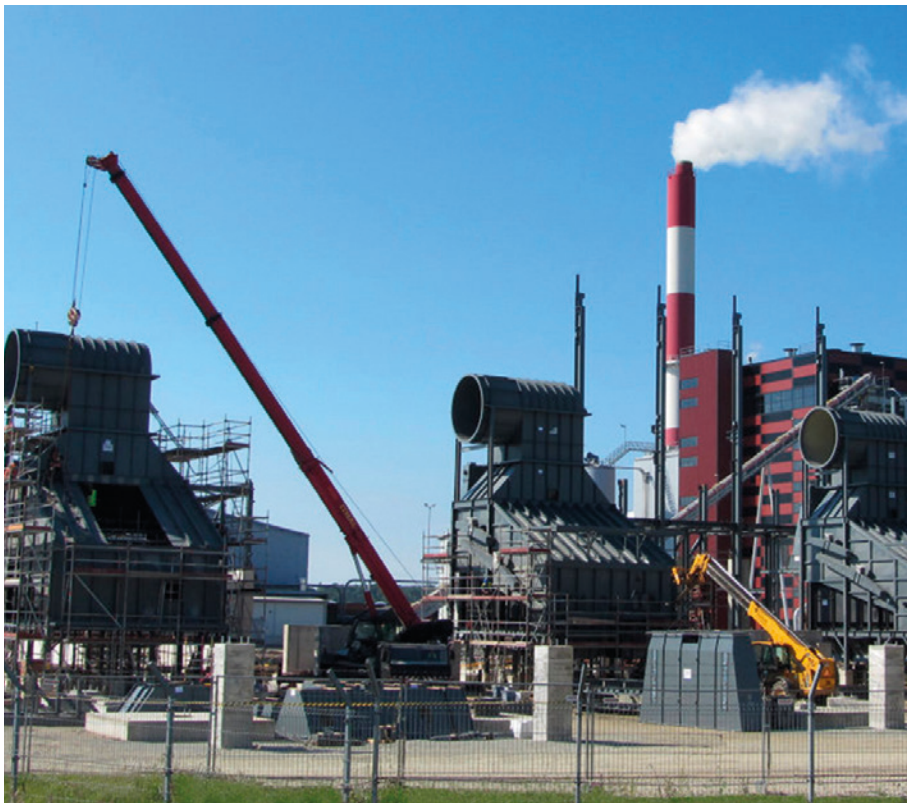
„Axis Technologies“ Taline statoma elektrinė
