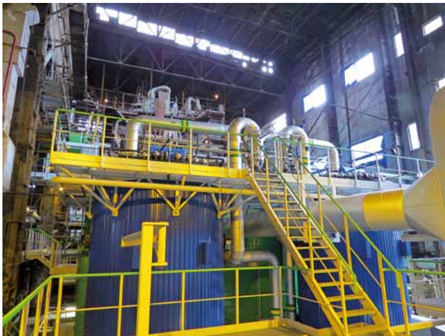
Petrašiūnų elektrinė iš vidaus
