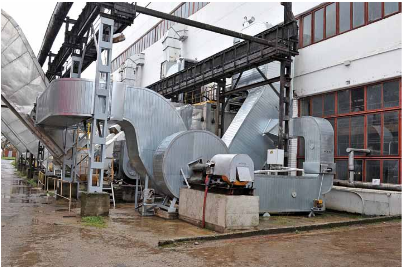
7 pav. Sumontuotos dūmų recirkuliacijos sistemos bendras vaizdas
